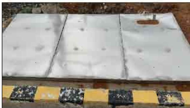
三级隔油沉淀池
