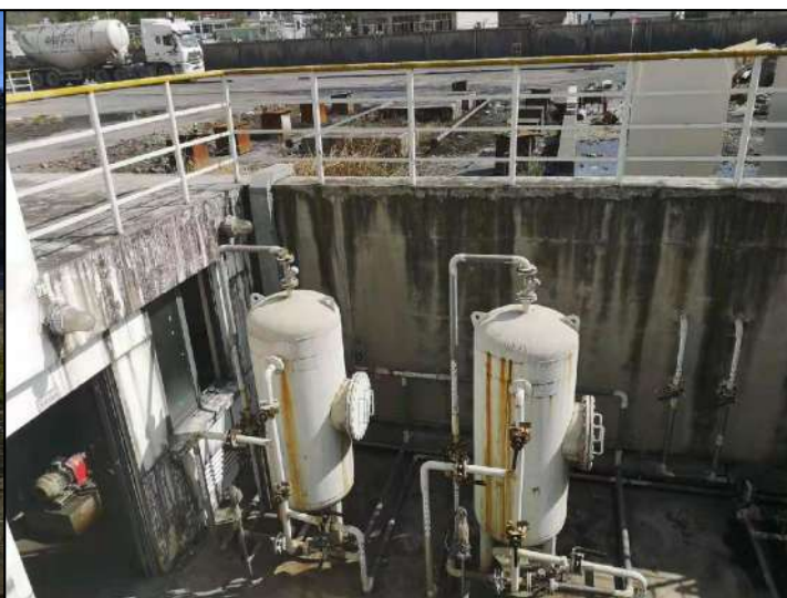
生活污水处理站
