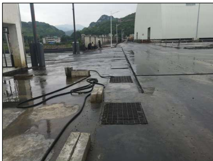
车辆冲洗沉淀池
