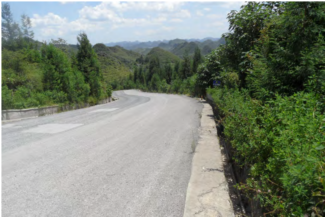
进厂道路治理现状(2020 年 6 月 16 日照)
