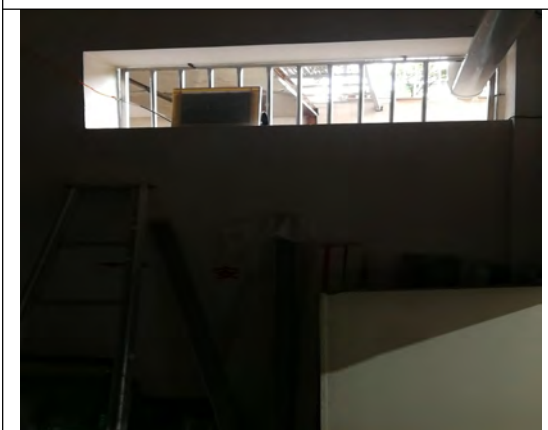
地下停车场排风扇 1
